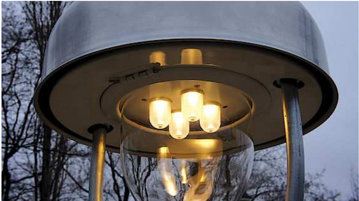
Auf LED-Leuchtmittel umgerüstete Gaslichtleuchte
